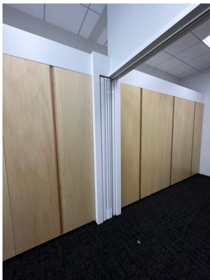
壁面造作家具、吊式可動間仕切り ／町会の事務所に神輿や神具の収納庫を 造りつけた
